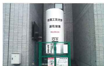
液体窒素の貯槽
