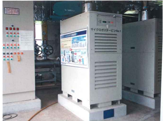
図2 コジェネレーションシステムの外観 (北見市浄化センターにて)
