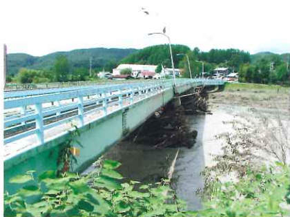
流木の集積により傾いた橋梁
