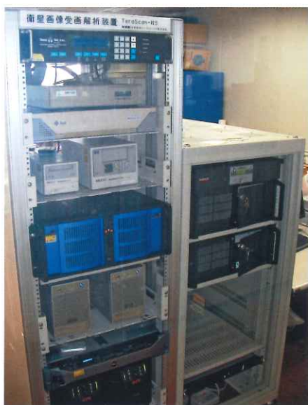
衛星受信室内装置
