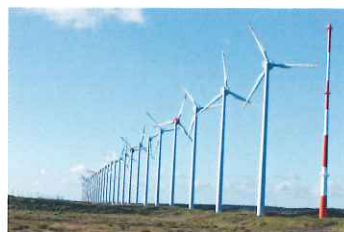
大規模風力発電所（北海道）
