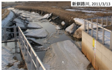
写真-1 津波発生後樋門吐口水路内に残された滞留氷板
