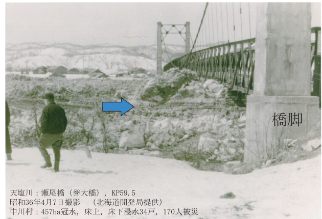
写真-2 天塩川の旧瀬尾橋(誉大橋)におけるアイスジャムの状況 (提供：北海道開発局)
