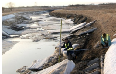
Photo.1 樋門吐口周辺で確認された巨大氷板群
