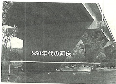
図-5 橋脚の根入れ不足
