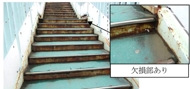
(c) 階段蹴上げの腐食状況
