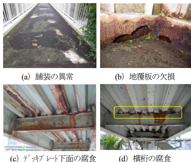
写真-1 損傷状況 2)
