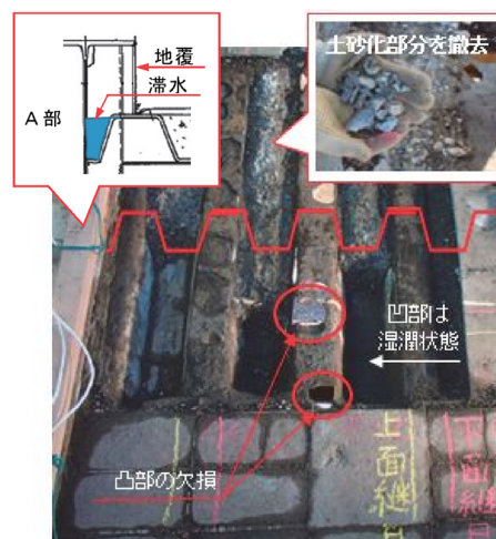
図-2 デッキプレート上面の損傷状況 7)
