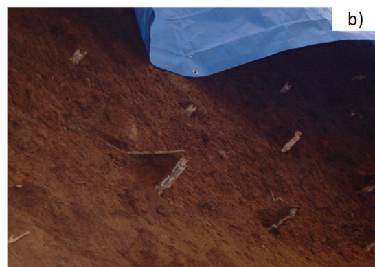
写真-1 凍上現象による補強土壁の被害例 2) (a: 壁面パネル脱落の様子, b: 連結部の損傷)
